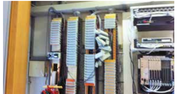
Ausgedient: die 15-jährige Telefonanlage wurde ersetzt
