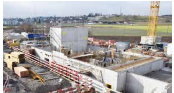
Nach dem Umbau kann die ARA Eich Mikroverunreinigungen aus dem Abwasser beseitigen
