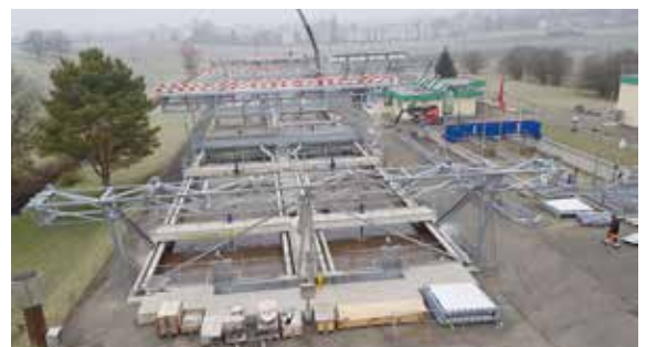
In der ARA Eich wurde eine moderne Photovoltaikanlage gebaut
