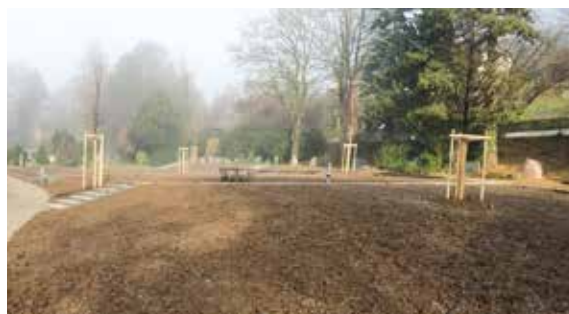
Die Terrainanpassung auf dem Friedhof mit Gestaltung der Gehwege konnte im Herbst abgeschlossen werden
