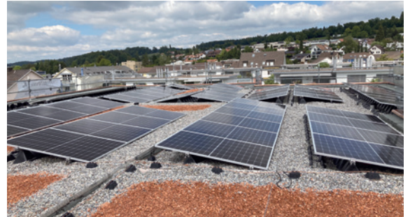
Photovoltaikanlage Schulanlage Geeren: Inbetriebnahme im Herbst 2022.
