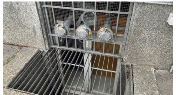
Neu: die umweltfreundliche Holzpellets-Heizung beim „Alten Dorfschulhaus“.
