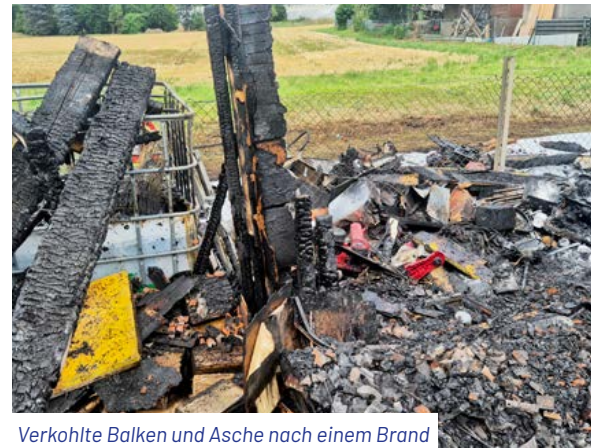
Verkohlte Balken und Asche nach einem Brand
