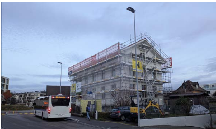
Sanierung und Umbau des alten Schulhauses an der Baltenswilerstrasse 10. Mitte 2026 wird die Abteilung Soziales das neue Verwaltungsgebäude der Gemeinde beziehen
